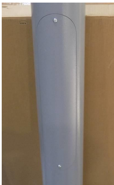
Trappe d'accès aux équipements électriques
